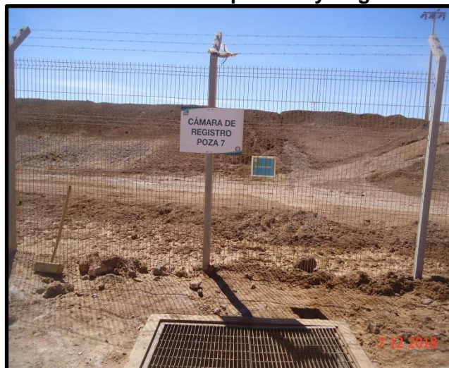
Figura 6. Vista Cámaras de Inspección y Registro Pozas 6 y 7
