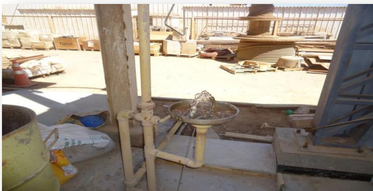
Fotografía N° 24 Lava ojos y ducha de bodega de Abastecimiento
