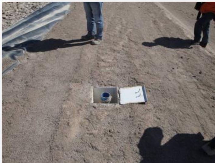
Fotografía N° 13 Vista sistema de inspección de infiltración
