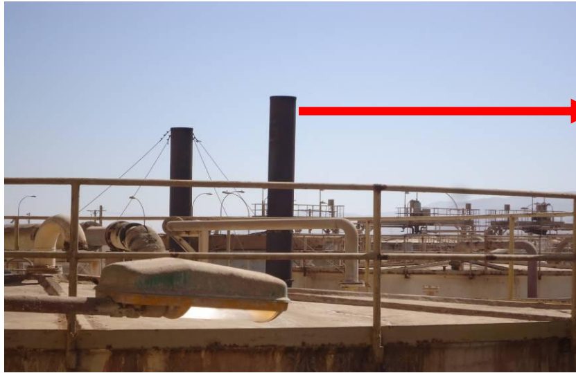
Fotografía N° 9 Puntos de muestreo chimenea de calderas
