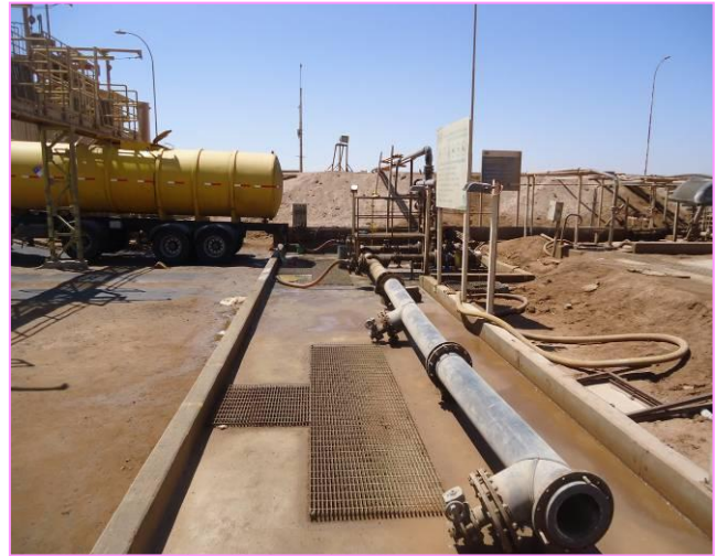
Zona de Descarga Salmuera
