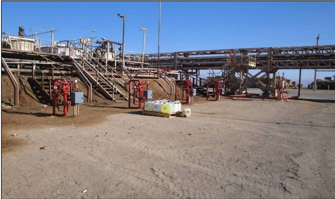
Fotografía N° 5. Planta de Remoción Boro
