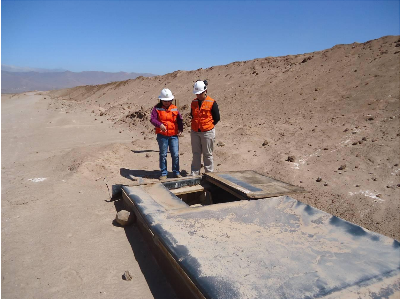
Fotografía N° 20; Cámara inspección filtraciones pozas
