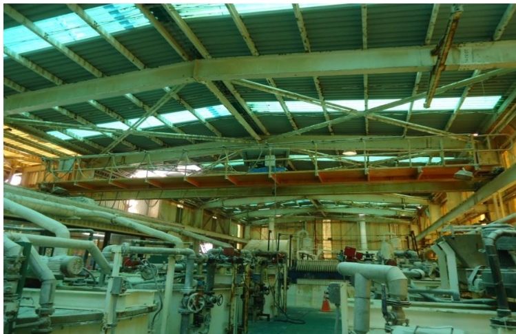
Fotografía N° 3: Área Filtrado y Prensas
