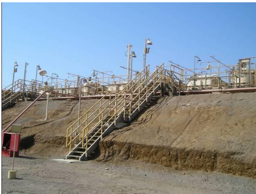
Foto 4. Planta de Remoción Boro (nuevas celdas)
