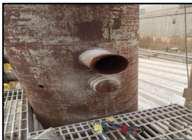
Fotografía 19 Punto de Muestreo MP Chimenea Caldera N° 1
