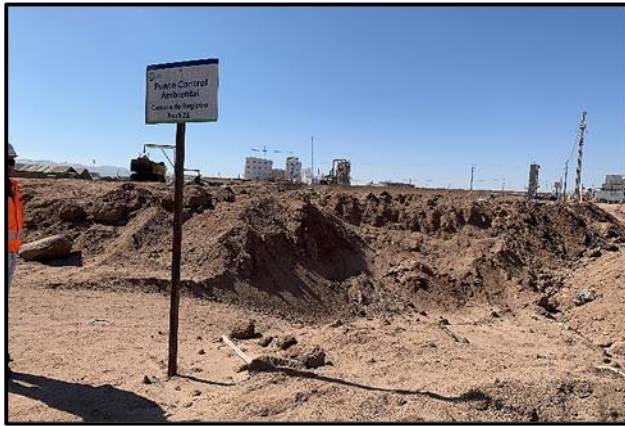
Fotografía 11 Cámara de Registro Pozo 21
