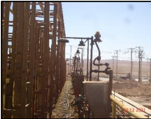
Fotografía 4: Planta de Remoción Boro, Tren de extracción
