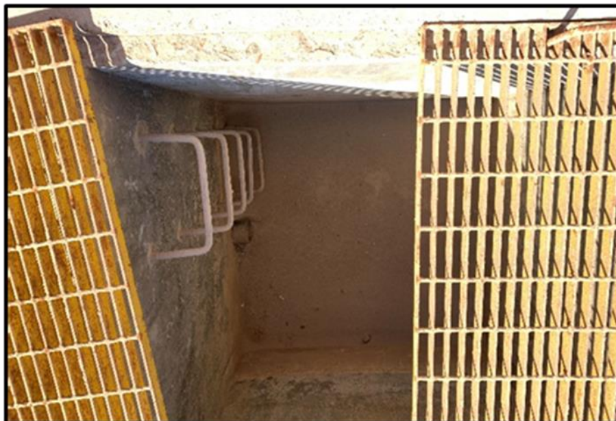
Fotografía 24. Vista Interior Cámara de Registro
