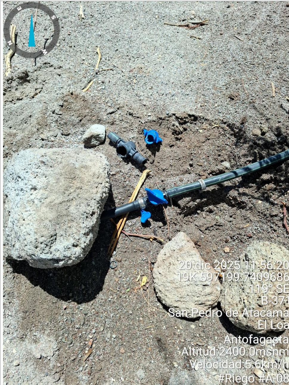
REPARACION SISTEMA DE RIEGO CERCANO A EJEMPLAR A-11 Y A-12 (VÁLVULA)
