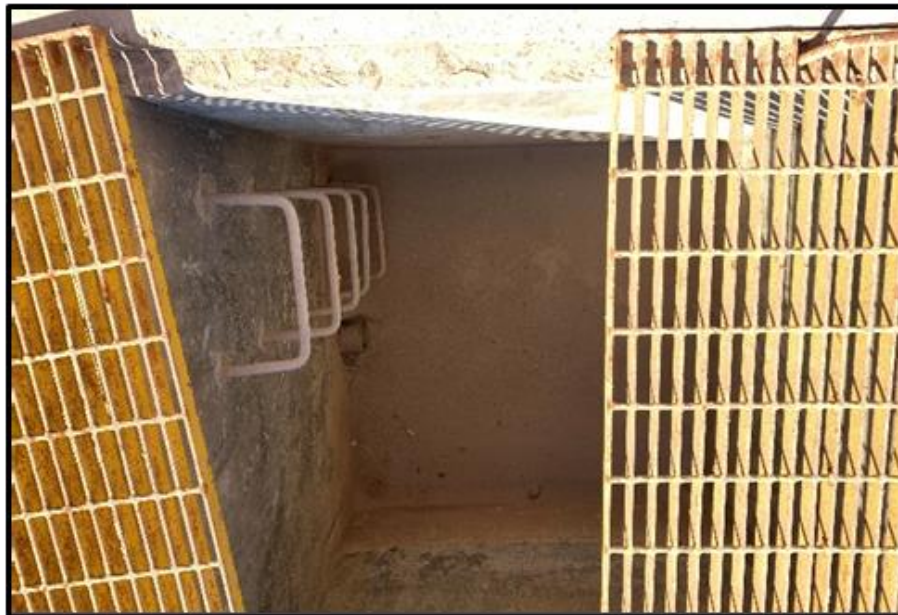
Fotografía 24. Vista Interior Cámara de Registro
