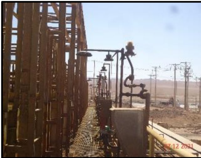
Fotografía 5 Planta de Remoción Boro, Tren de extracción
