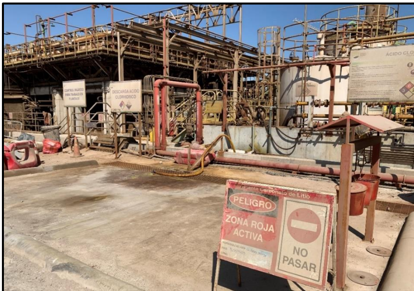
Fotografía 20. Zona de Descarga de Ácido Clorhídrico y Planta SX
