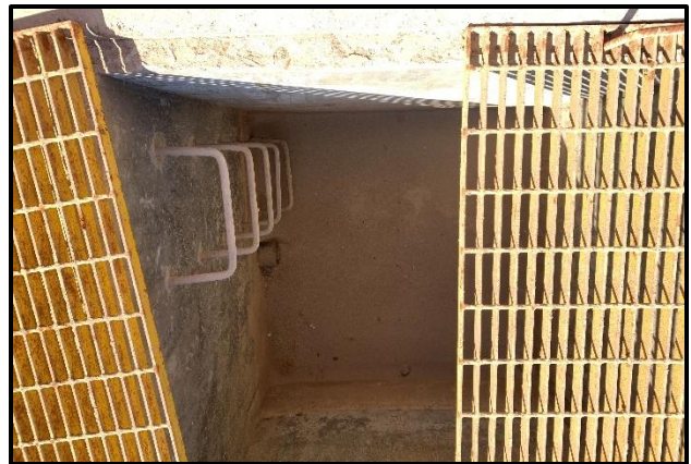
Fotografía 10 Interior Cámara de Registro
