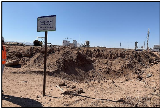
Fotografía 11 Cámara de Registro Poza 21
