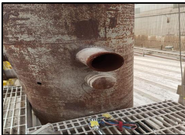
Fotografía 18. Punto de Muestreo MP Chimenea Caldera N° 1
