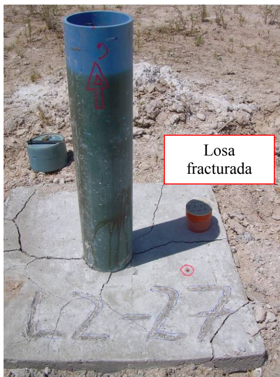
Foto 4-6. Colapso de losa de hormigón del Pozo L2-27
