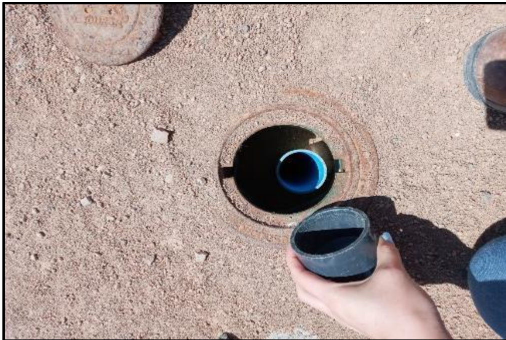
Fotografía 24. Piezómetros (28 de diciembre 2020)
