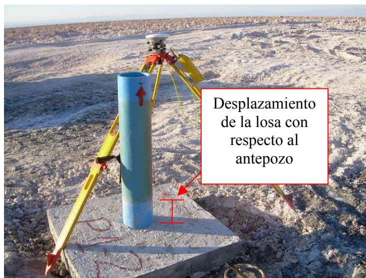
Fotografía 5.7-3. Desplazamiento de la losa con respecto al antepozo del Pozo P1-2
