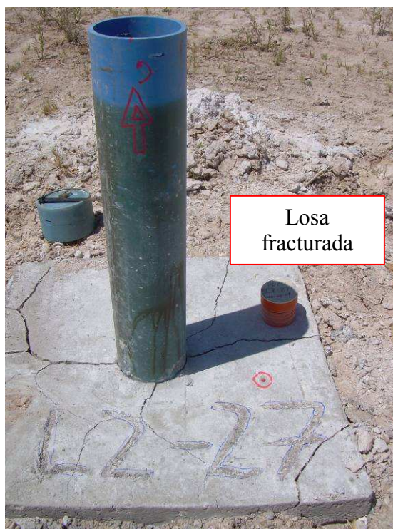
Fotografía 5.7-1. Colapso de losa de hormigón del Pozo L2-27
