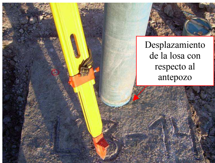
Fotografía 5.7-2. Desplazamiento de la losa con respecto al antepozo del Pozo L3-14
