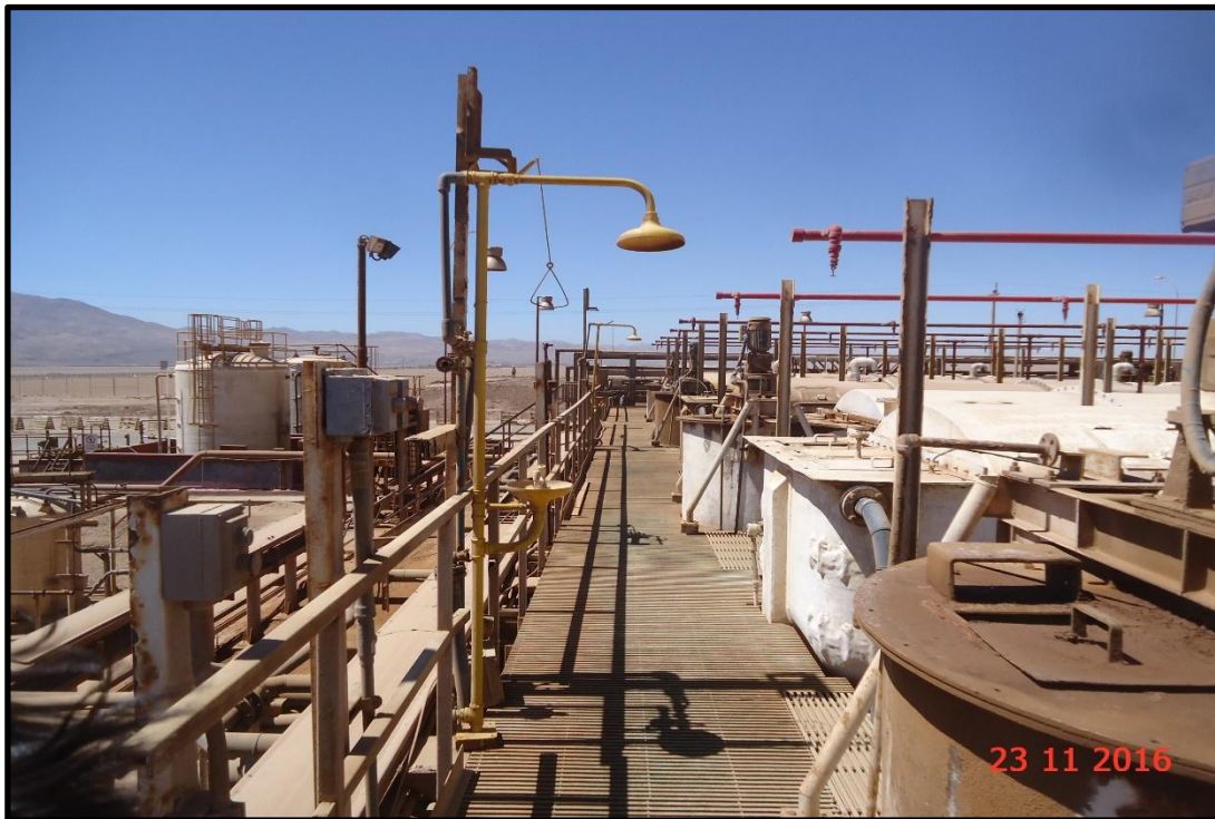
Fotografía N° 3: Planta de Remoción Boro
