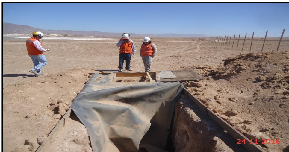
Fotografía N° 13: Cámara de Control Aguas Subterráneas
